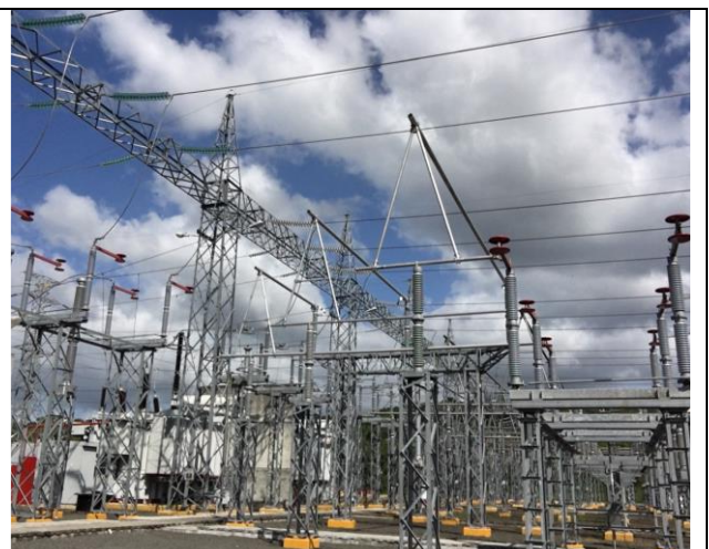
Foto # 2, Subestación Panamá II.
