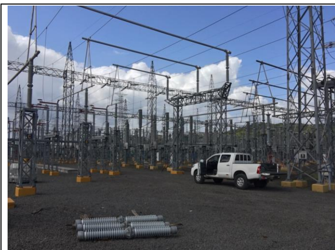
Foto # 1, Subestación Panamá II.
