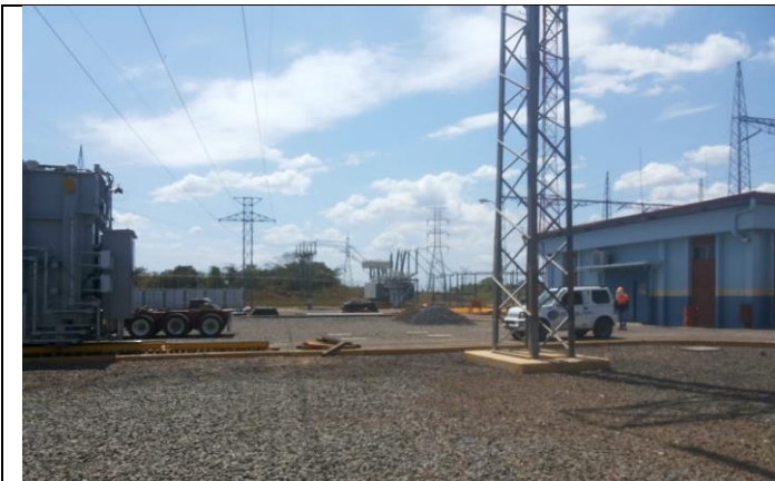
Foto # 1, Movimiento de la cuba del T2, S/E Llano Sánchez.
