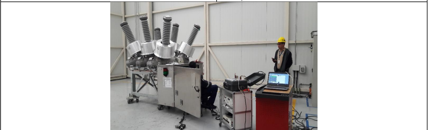
Foto # 3, Pruebas de relación y polaridad a los CTs de los interruptores de 34,5 kV en fábrica.
