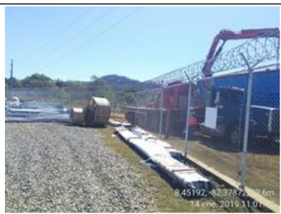
Foto # 2, Suministro de cable AAC Corepsis.
