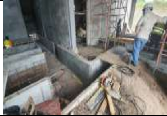
Foto # 4, Canaletas internas de casa control en Subestación Llano Sánchez.
