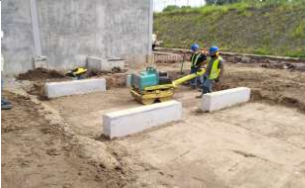
Foto # 5, Pedestales de Intercambiador de calor en Subestación Llano Sánchez.
