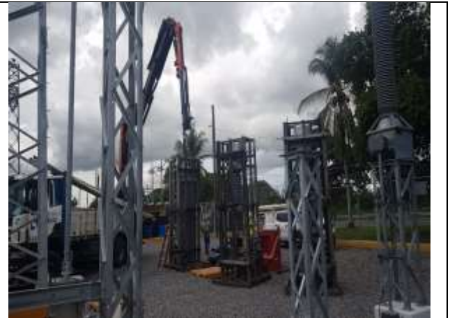
Foto # 4, Montaje de SMEC en la futura posición de la línea 230-10 en la S/E Progreso
