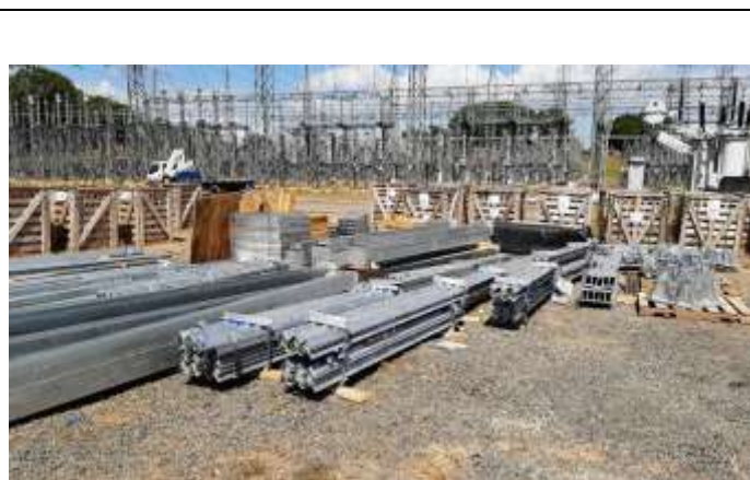
Foto # 2 , Estructuras metálicas que se han recibido en S/E Panamá II
