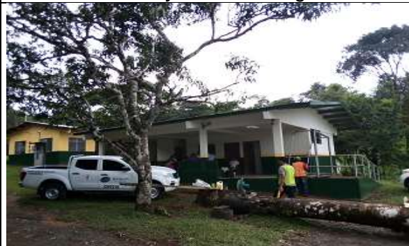
Foto #6, Culminación de la remoción del centro de salud de cerro Venado.
