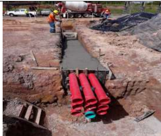
Foto # 2, Vigaducto de 34.5 kV en Subestación Llano Sánchez.
