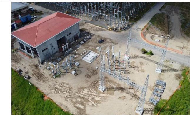
Foto # 7, Panorámica de la Subestación Panamá II.
