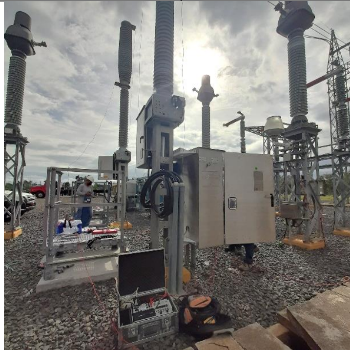
Foto # 3, Instalación de interruptor 23B42 en subestación Veladero.
