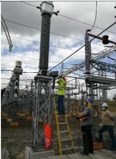
Foto # 9, Prueba de resistencia de aislamiento de CTS de 230kV, nave 1, en subestación Panamá II.
