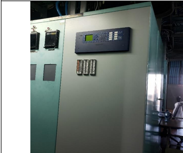
Foto # 5, Reemplazo de protecciones para las futuras posiciones de las líneas 230-9A y 230-39 en subestación Mata de Nance.
