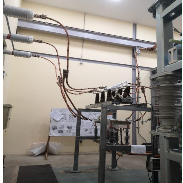
Foto # 2, Cableado hacia las cuchillas LBS en subestación Llano Sánchez.
