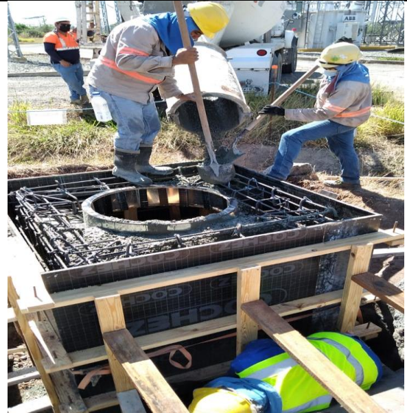
Foto # 4, Cámara de vigaducto hacia casa control en subestación Llano Sánchez.
