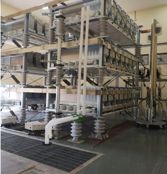
Foto # 1, Instalación de tuberías para enfriamiento por agua en subestación Llano Sánchez.
