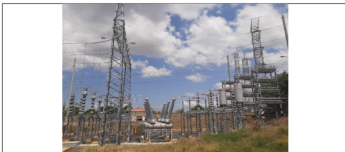
Foto # 1, Integración de Banco de Capacitores CS4 de la subestación Llano Sánchez
