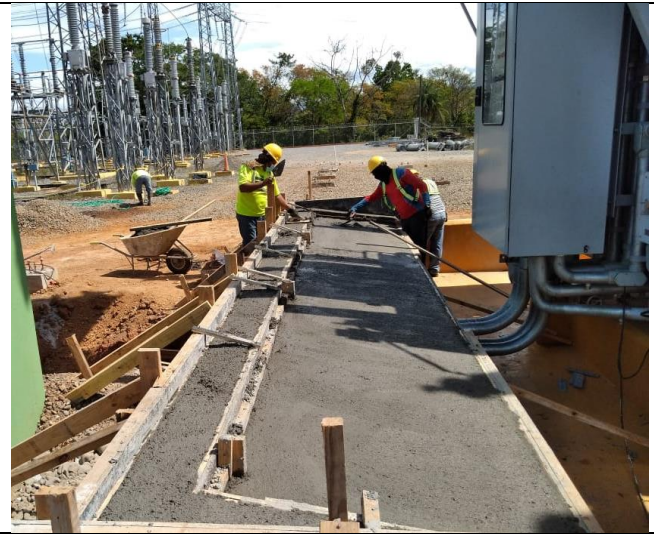
Foto # 2, Rampa de piscina del nuevo transformador T1 en subestación Mata de Nance.
