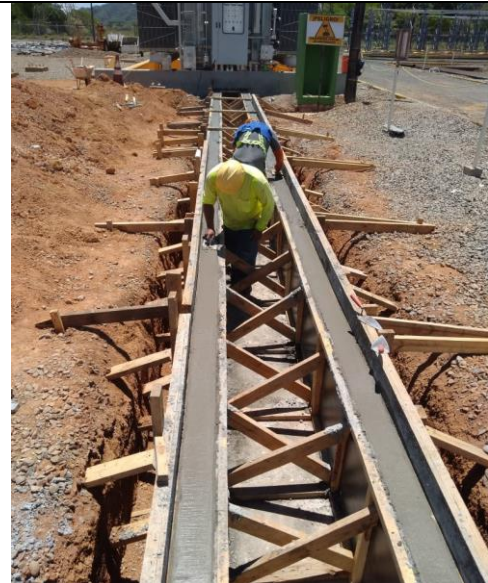
Foto # 4, Canaleta de conexión del nuevo transformador subestación Mata de Nance.
