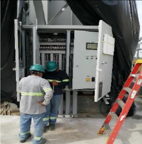
Foto # 7 Reparación de puerta y pintura del panel de control del transformador principal del proyecto STATCOM
