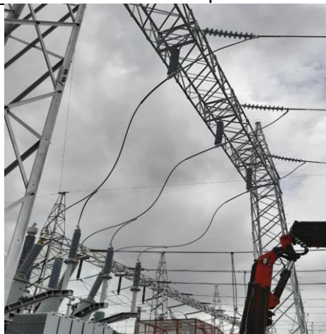
Foto # 3 Conexión de transformador a vano aéreo
