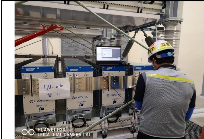
Foto # 1, Pruebas a válvulas STATCOM
