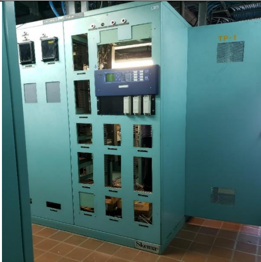
Foto # 3, Reemplazo de protecciones para las futuras posiciones de las líneas 230-9A y 230-39 en subestación Mata de Nance.
