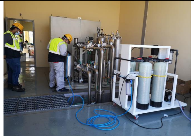
Foto # 2, Llenado del sistema de enfriamiento por agua
