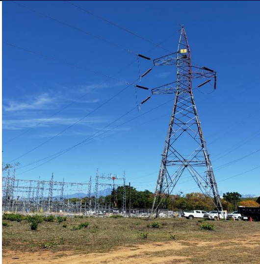
Foto # 1, Relocalización de las líneas 230-5B y 230-6C en subestación Mata de Nance.
