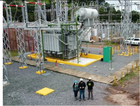
Foto # 2 T2 de Subestación Panamá energizado
