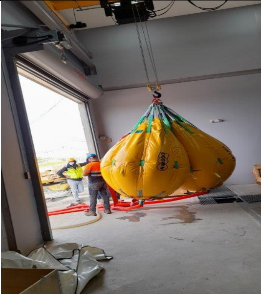
Foto # 5. Proceso de llenado de las bolsas de agua para pruebas de carga de las grúa puente de Valve Hall 1 y 2.
