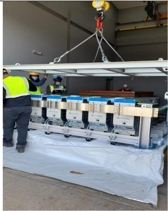
Foto # 8 . Montaje de módulos para la instalación de las válvulas del STATCOM.
