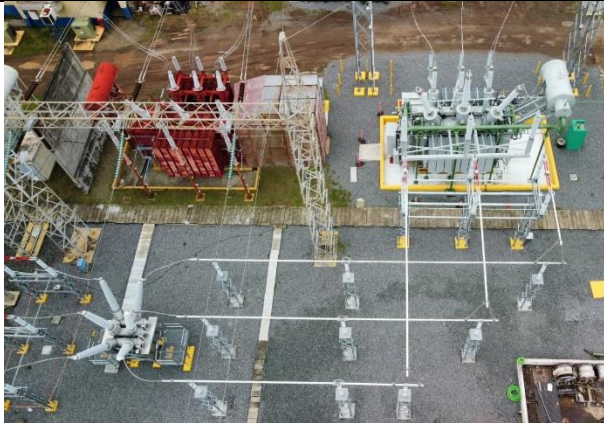
Foto # 1 T2 de Subestación Panamá energizado
