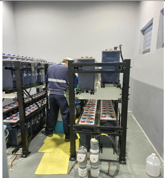
Personal de la Casa de las Baterías realizando el llenado de ácido, previo al inicio de las pruebas de comisionamiento.
