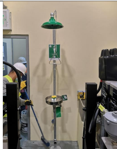
Foto # 6 Instalación de ducha de emergencia
