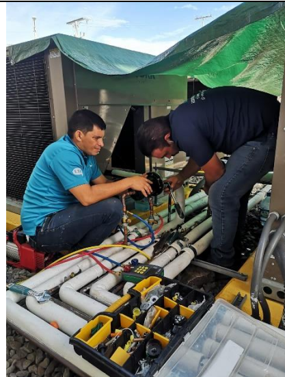
Pendientes de sistema de aire acondicionado
