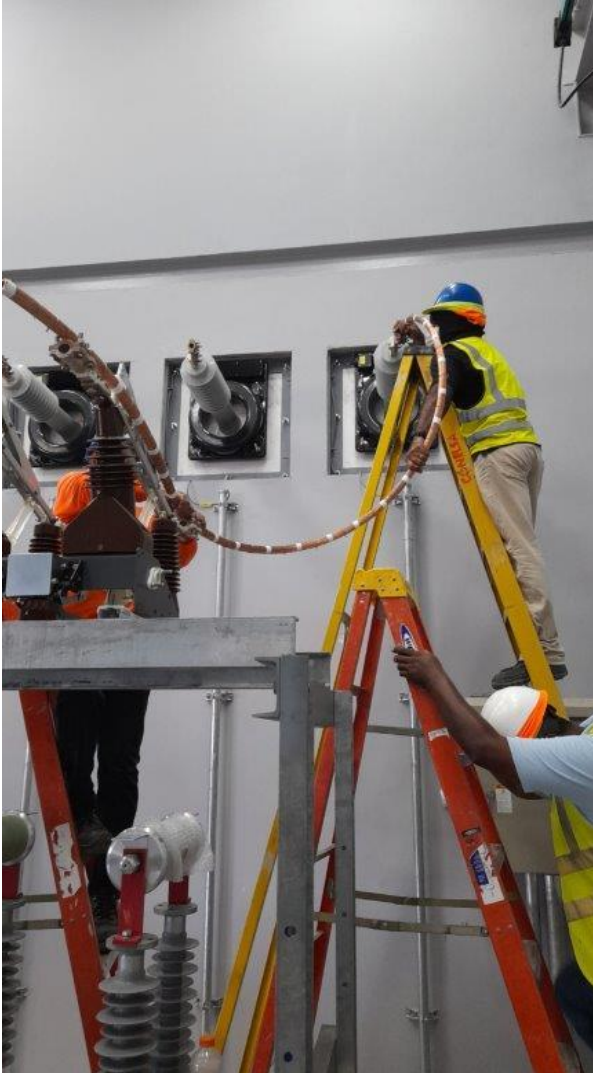
Foto # 3, Puentes de los Wall bushings, cuchillas y valvulas
