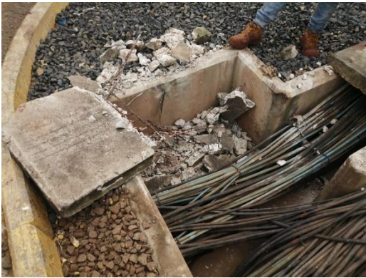
Foto # 7, Canaletas afectadas por camión de recolección de lodo.
