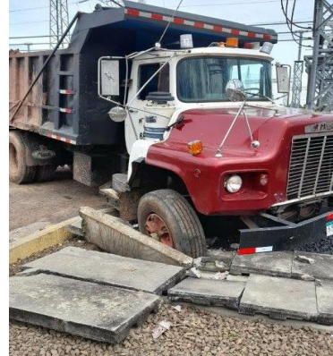
Foto # 8, Canaleta afectada por camión de recolección de lodo.
