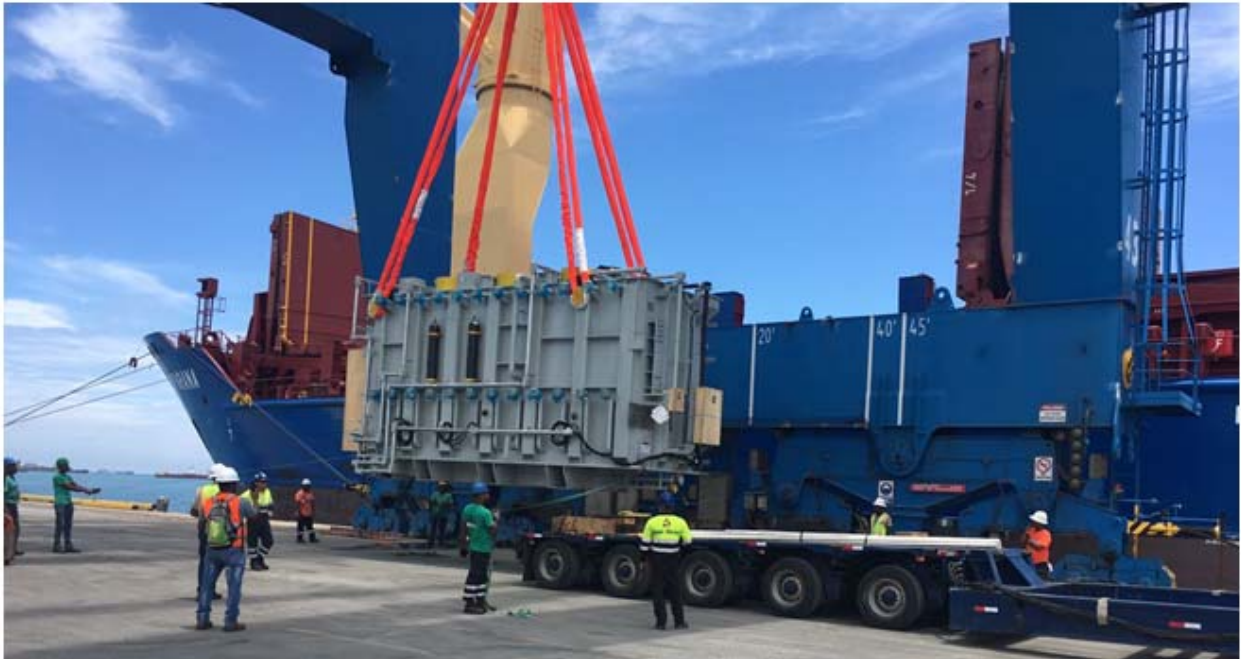
Proceso de carga del autotransformador T2 de Llano Sánchez a su respectivo vehículo de transporte.
