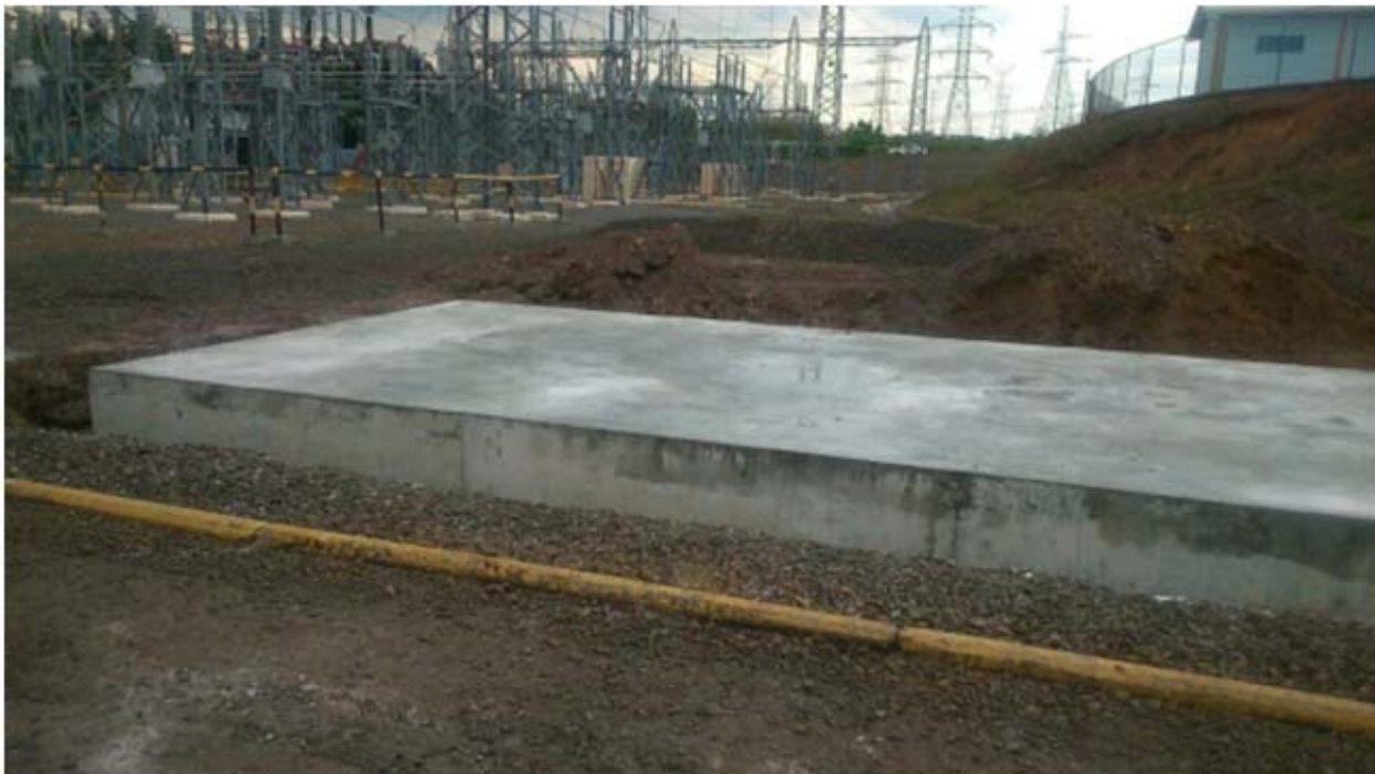
Base temporal para el autotransformador T2 de la subestación Llano Sánchez finalizada, vista frontal.
