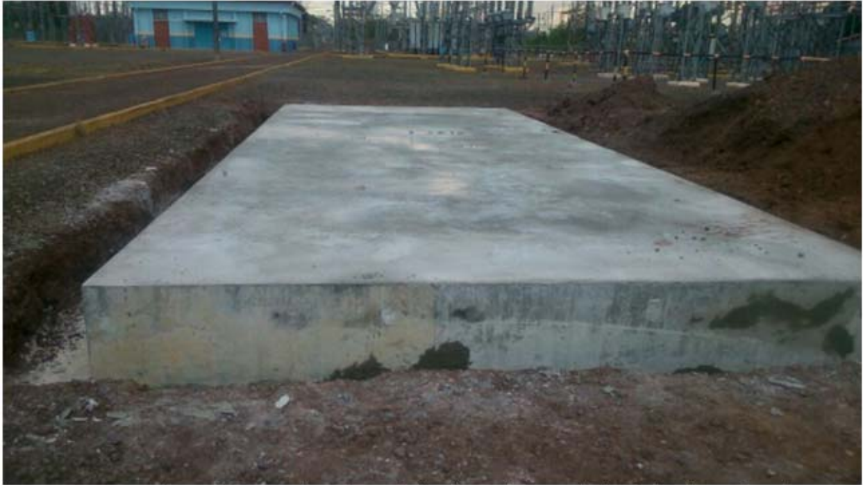
Base temporal para el autotransformador T2 de la subestación Llano Sánchez finalizada, vista lateral.
