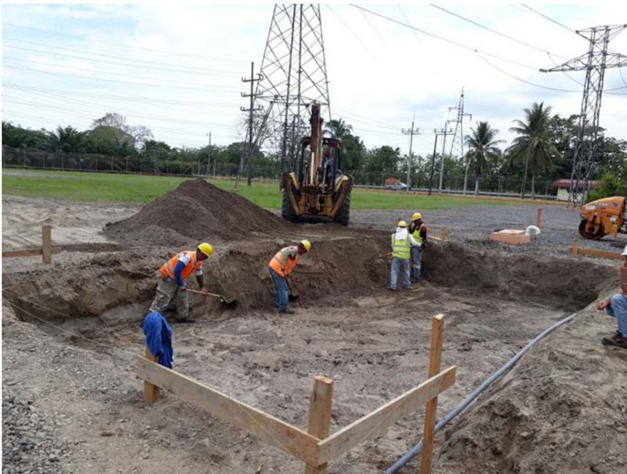
Primera etapa de los trabajos de civiles de la plataforma temporal para el nuevo T1 de la subestación Progreso.
