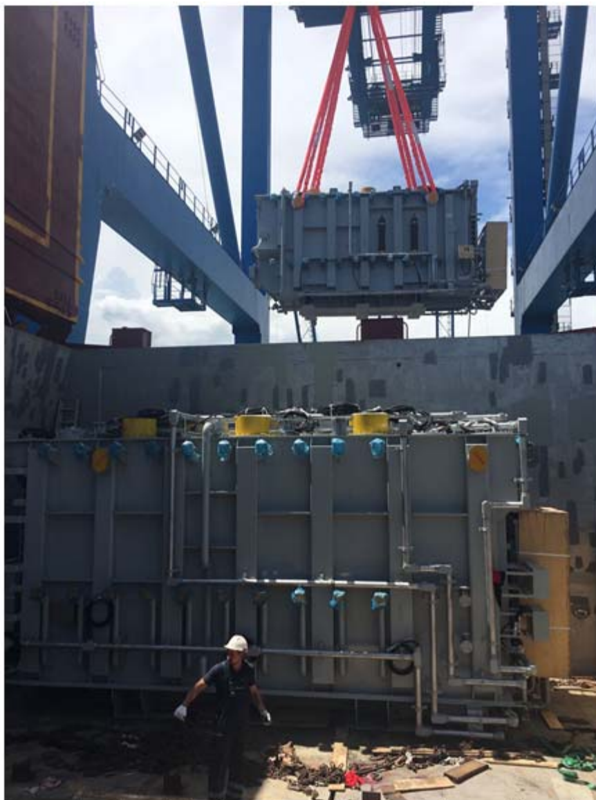
Proceso de descarga de ambos autotransformadores del barco que los transportó a puertos panameños.
