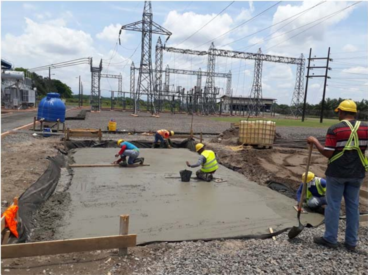
Proceso de tallado de la base temporal del autotransformador T1 de la subestación Progreso.
