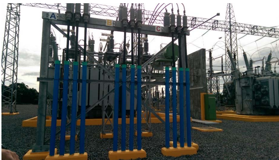
Vista del transformador T2 energizado
