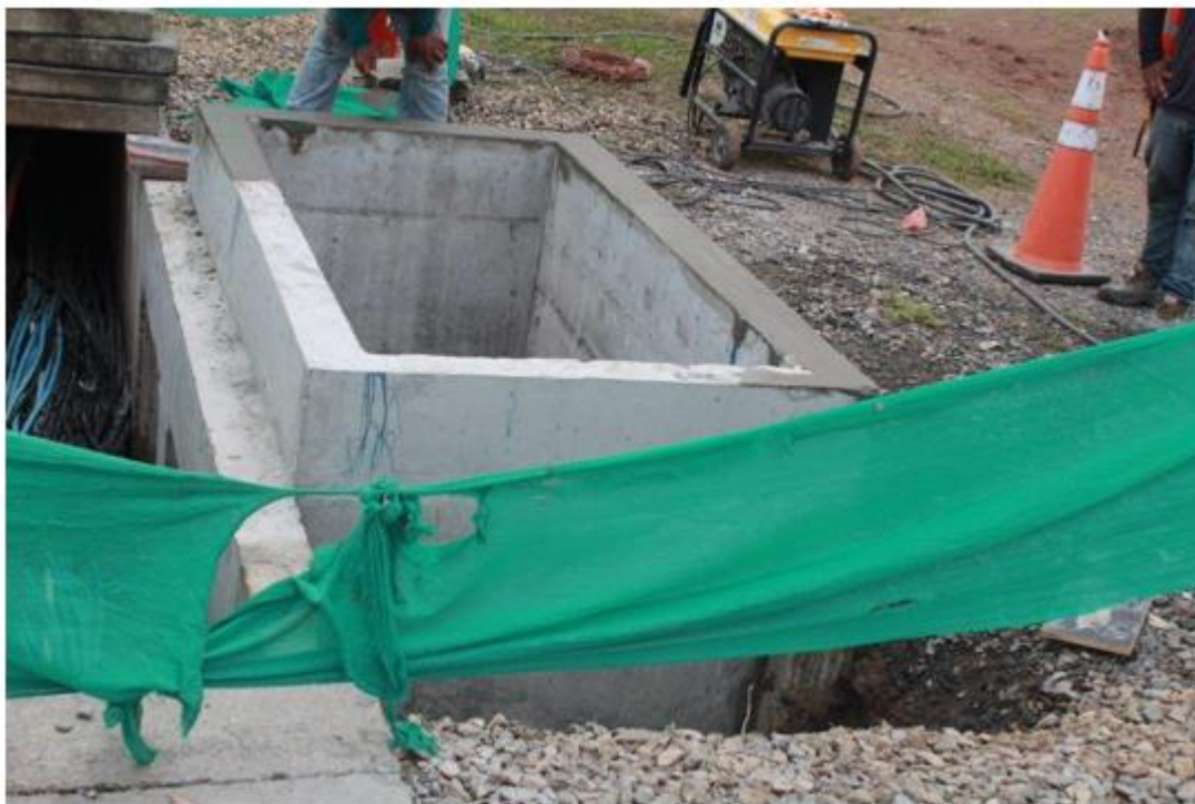
Cámara de transición entre shelter de 230 kV y Patio de 230 kV
