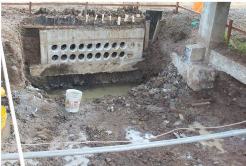
Excavación de la cámara de mantenimiento entre el shelter de 115 kV y el shelter de 230 kV
