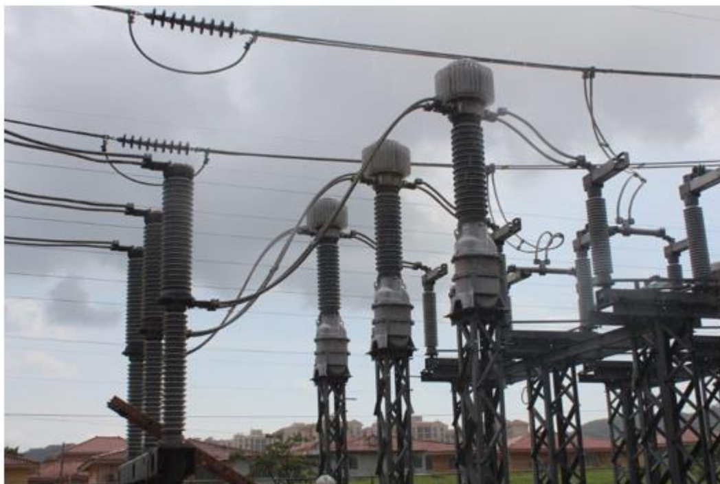
Conexión de la barra secundaria del interruptor 11M72 con transformadores de corriente
