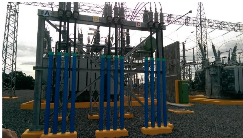
Vista del transformador T2 energizado
