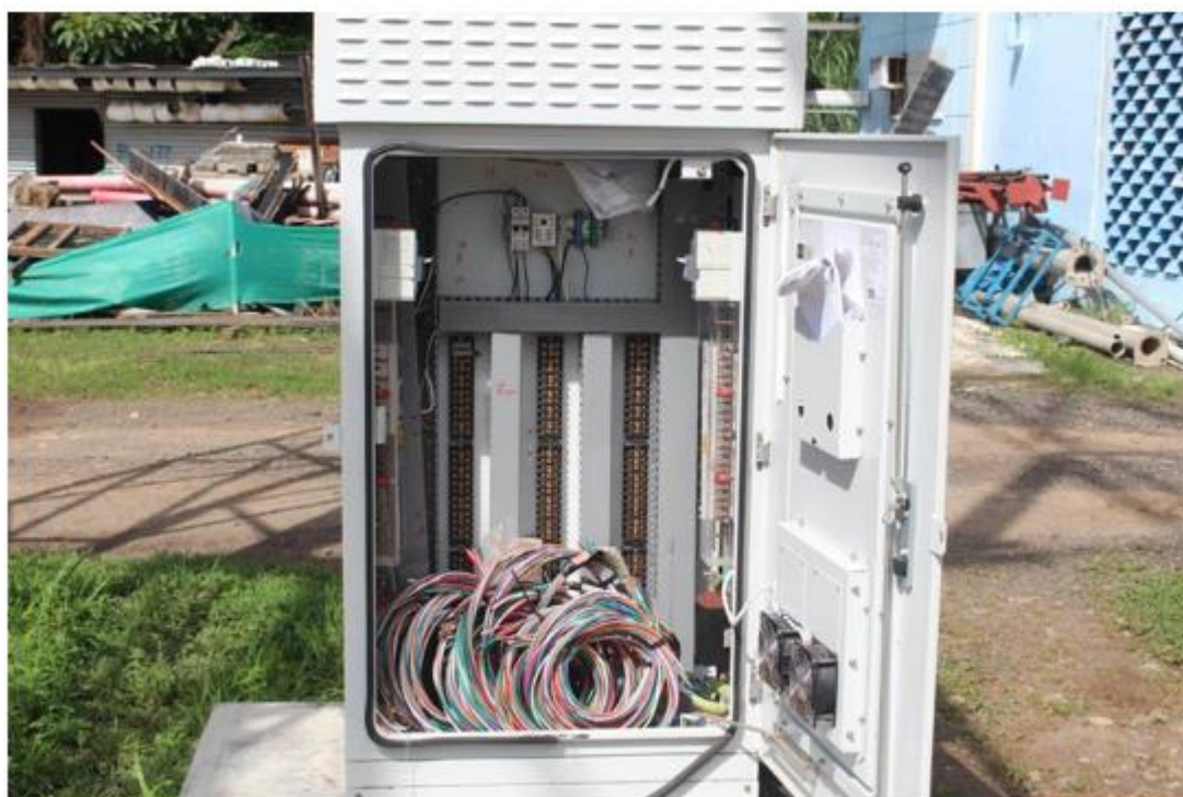
Cables preparados para el conexionado en caja de centralización CCN13
