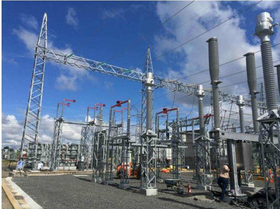
Patio de 230 kV
