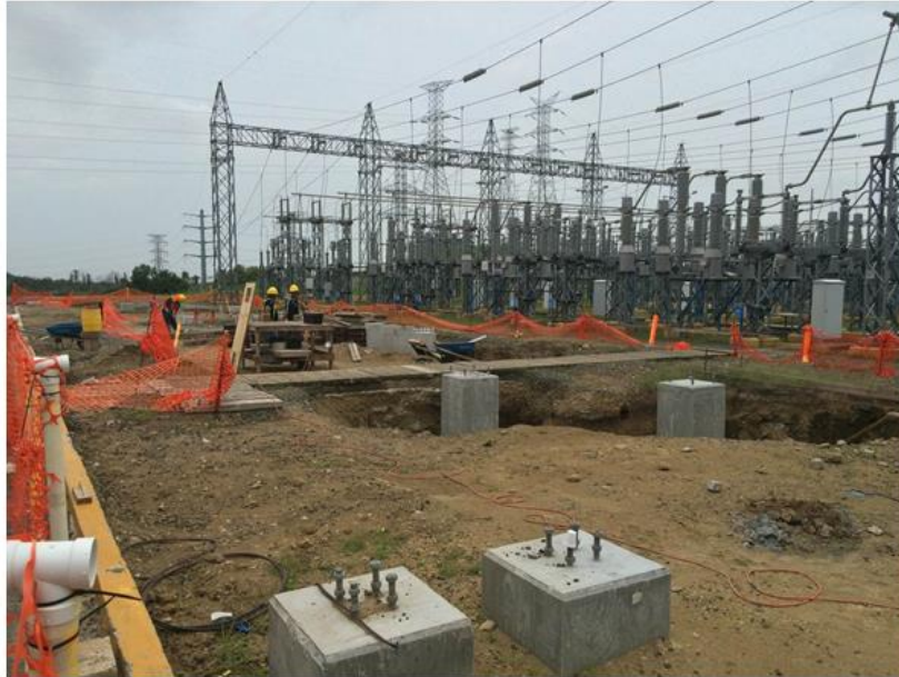
Patio de 115 kV
