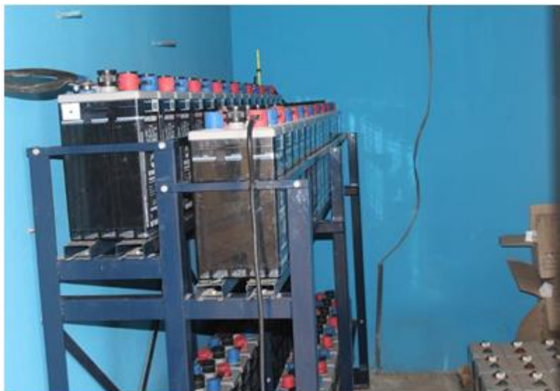
Banco de baterías No.2 puesto en servicio
