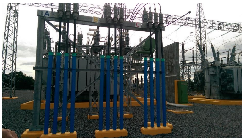
Vista del transformador T2 energizado
