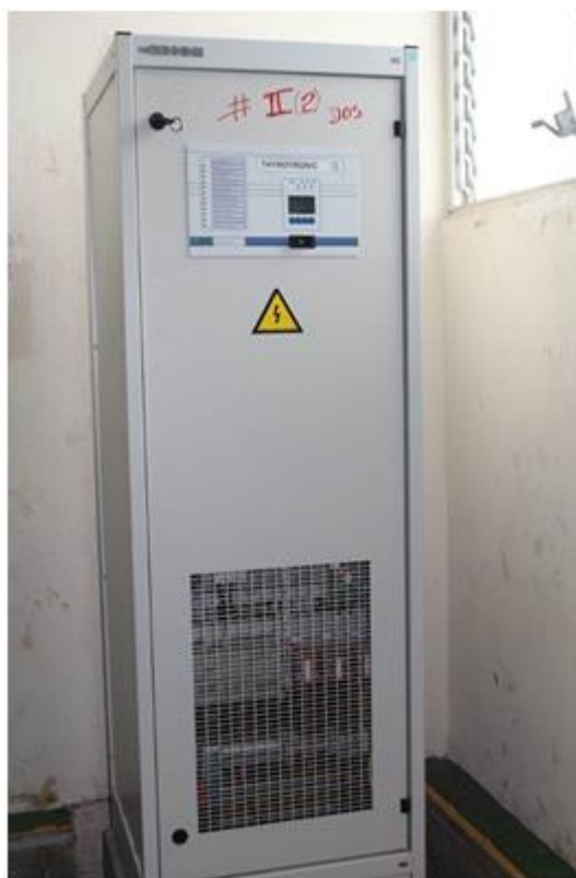
Cargador de baterías No.2 puesto en servicio
