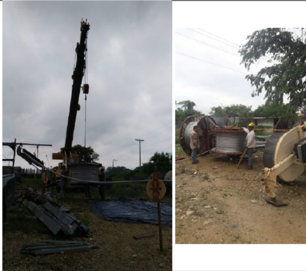
Rebobinado del conductor ACAR 1200 (45Km)
