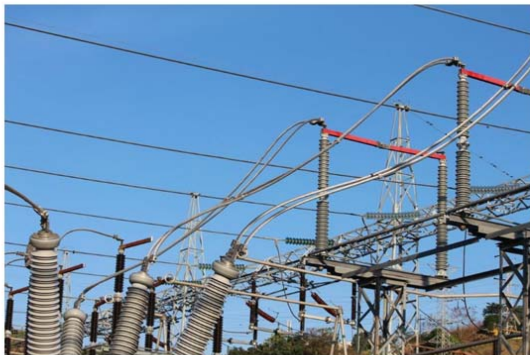
Montaje de la Barra Secundaria en la Bahía 4 del Patio de 230 kV
