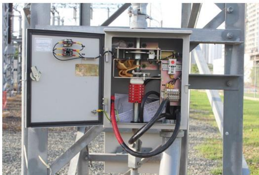
Instalación de los cables de la cuchilla de puesta a tierra NT5
