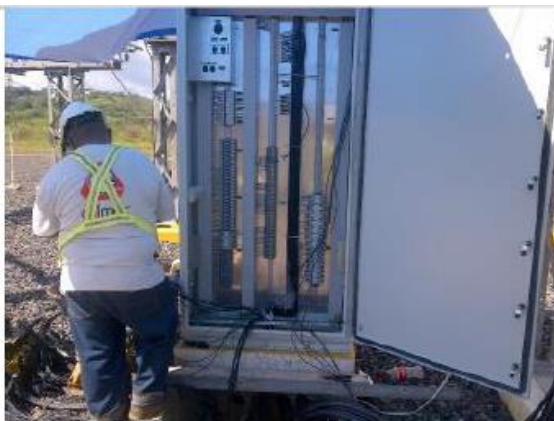
Conexionado MK M Nave 12 - SE Veladero
