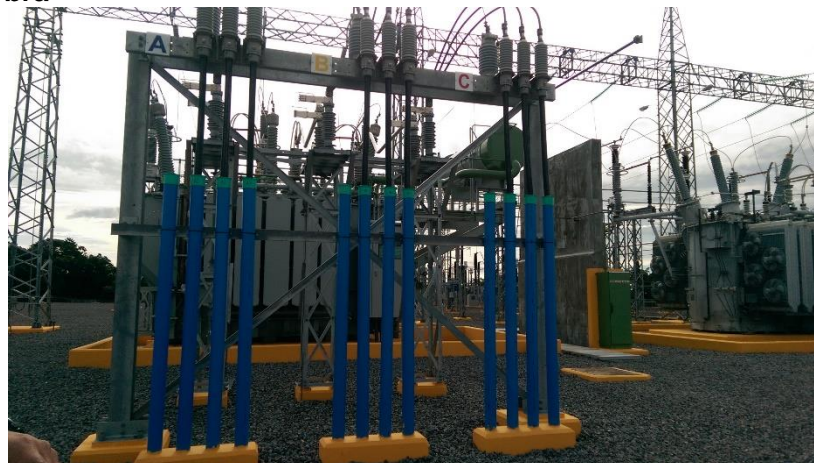
Vista del transformador T2 energizado
