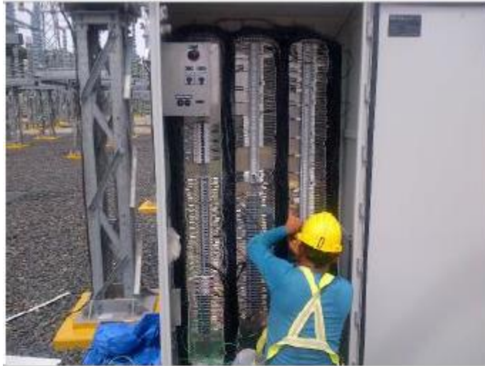
Conexiónado MK M Nave 6 – SE Llano Sánchez
