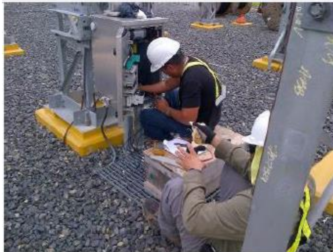
Verificación de Puntos – SE Llano Sánchez
