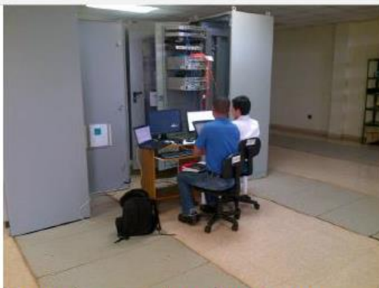
Prueba de Comunicación con los Equipos Existentes – SE Veladero
