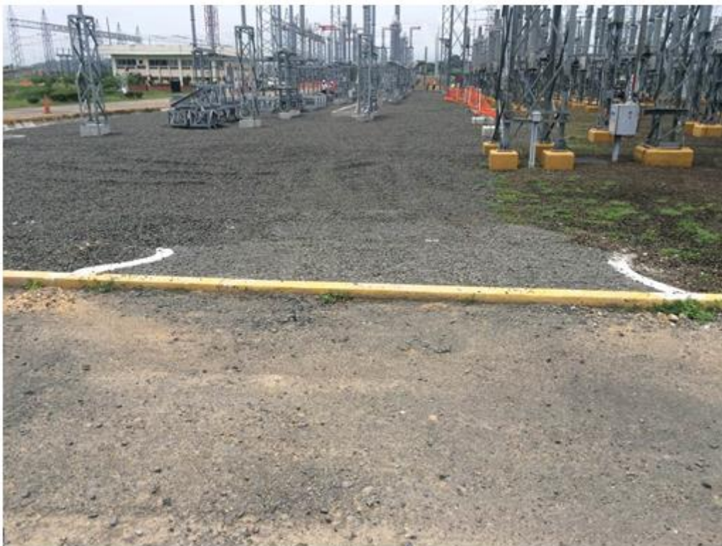
Patio de 230 kV
