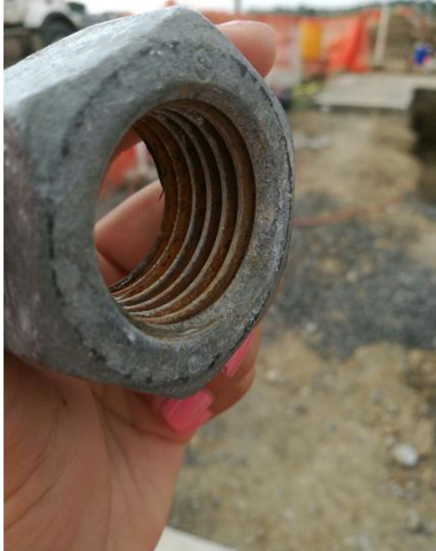
Oxidación en las estructuras Celosía de los equipos de patios.
