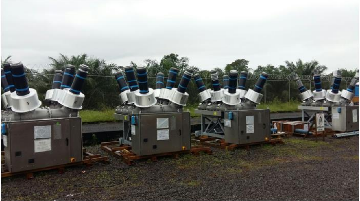
Interruptores nuevos de 34.5 kV en el sitio de la obra.
