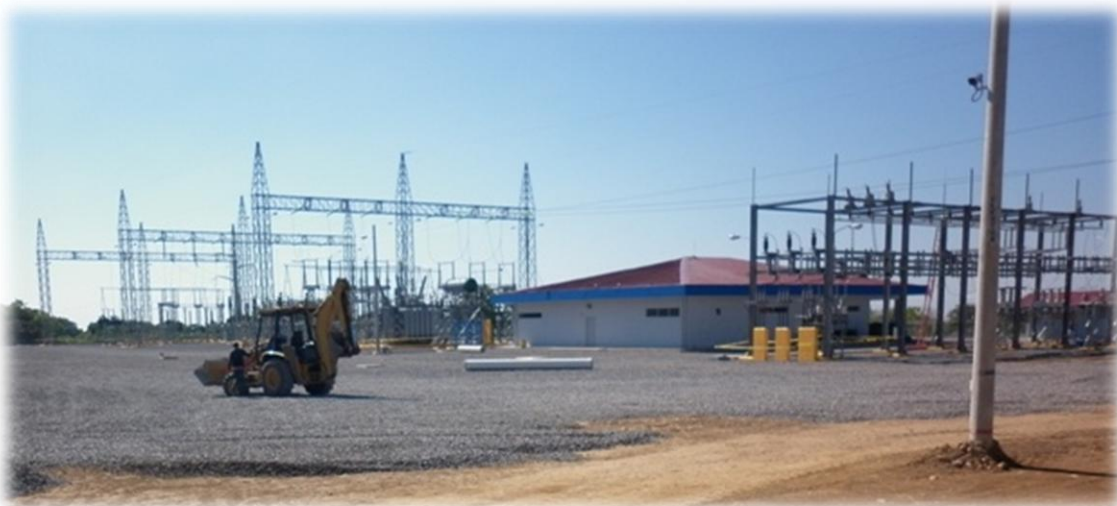
Patio 230kV Subestación Boquerón 3
