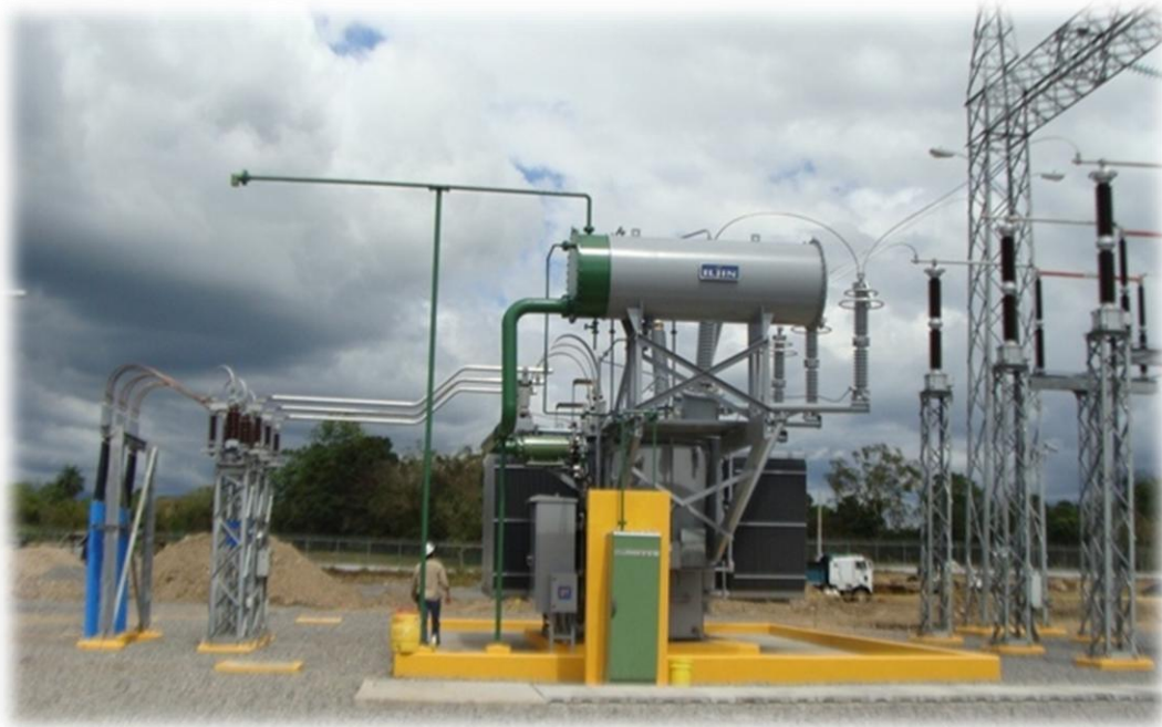
Instalaciones de la Subestación Boquerón 3 Equipos Electromecánicos del Patio de 230kV, Casa Control y Patio 34.5kV
