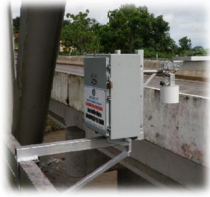
Estación hidrológica Tipo Radar instalada en el puente sobre el río Chiriquí Viejo en la carretera Interamericana
