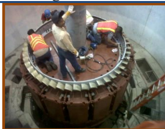
Vista del rotor de unidad generadora G1 de CH. Bajo de Mina – gira agosto 2010
