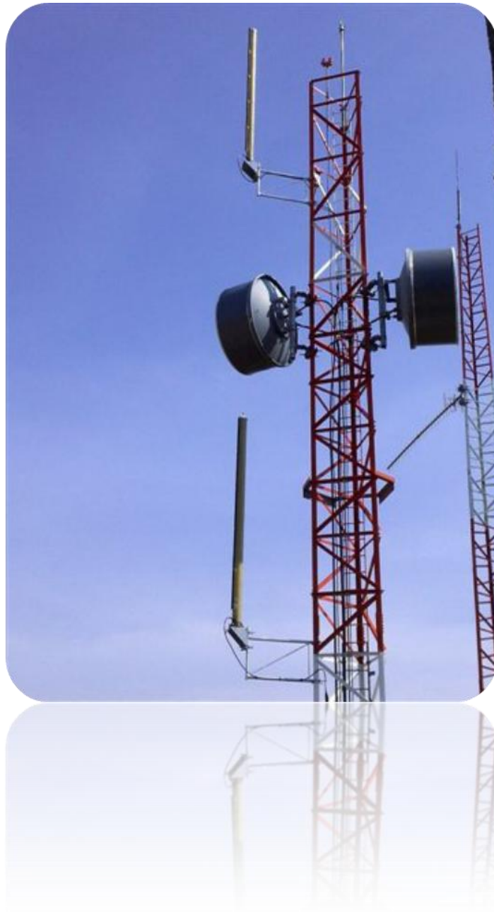
Antena de Comunicación de ETESA
